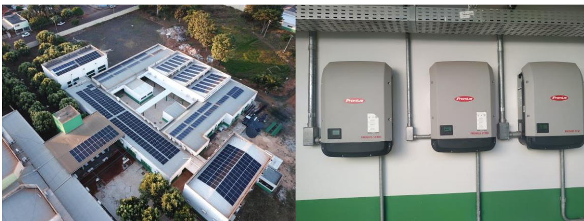
Figura 4. Sistema solar instalado no campus.
